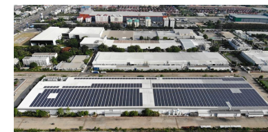
タイ最大級の太陽光パネル (バンパイン工場)
