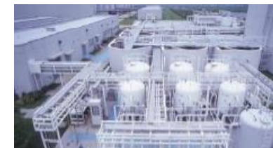
上海工場排水処理センター
