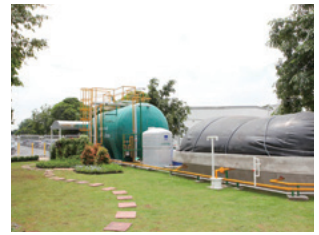
バイオガス発生設備
