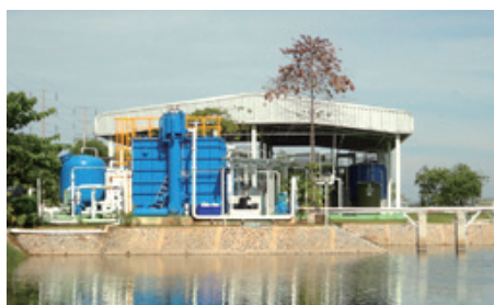
バンパイン工場の雨水池と雨水再利用設備
