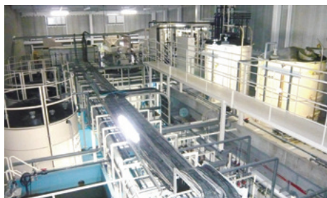
藤沢工場の排水処理設備
