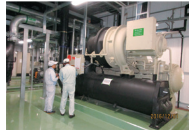
中国・西岑工場に導入されたターボ冷凍機
