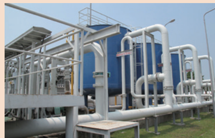
工場排水ゼロシステムのための設備
