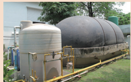
バイオガス貯蔵タンク
