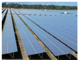
SchneiTec社にて設置済みの太陽光発電システム
